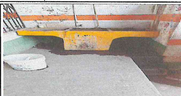
Foto 8: sustitución de pila por deterioro y fuga de agua
