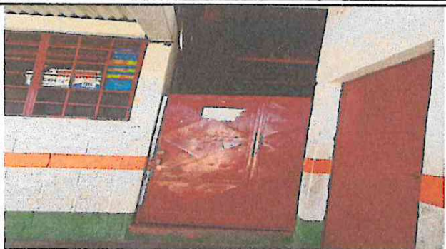
Foto 1: sustitución de puerta, la cual se encuentra pequeña y deja el aula vulnerable e insegura.
