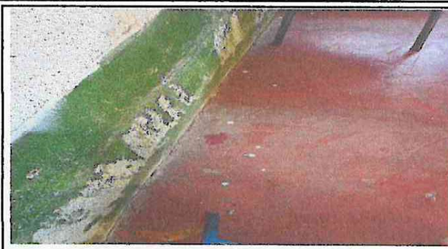
Foto 2: reparación de piso de cemento liquido, por piso cerámico, la cual esta muy gretada y en invierno se filtra el agua de lluvia.
